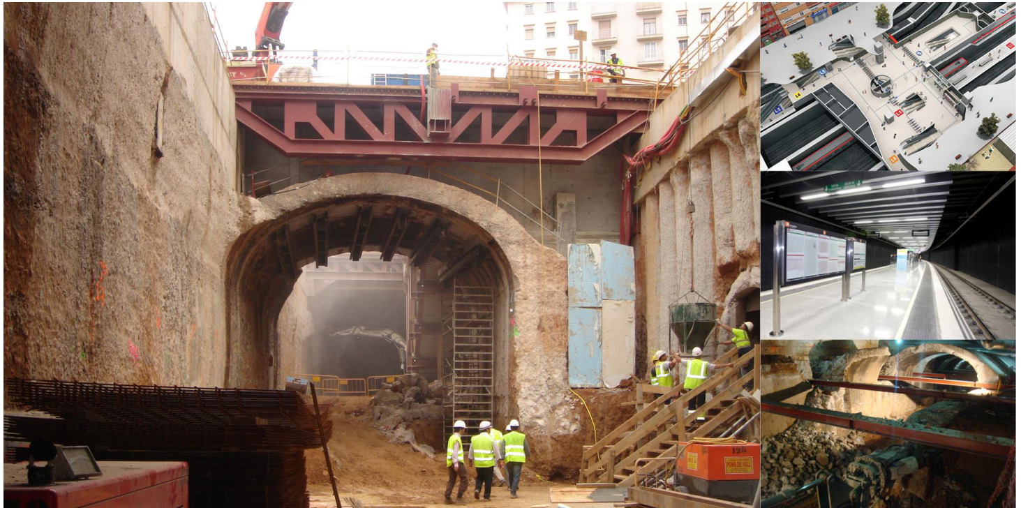
Construcción de nueva estación tras demolición de túnel existente y rebaje de la cota de vías
